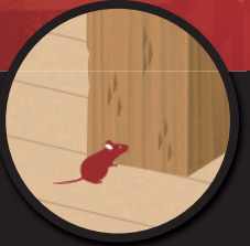
柱や壁面に かじられたあとがある
